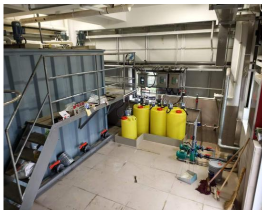
污水处理站加药间
