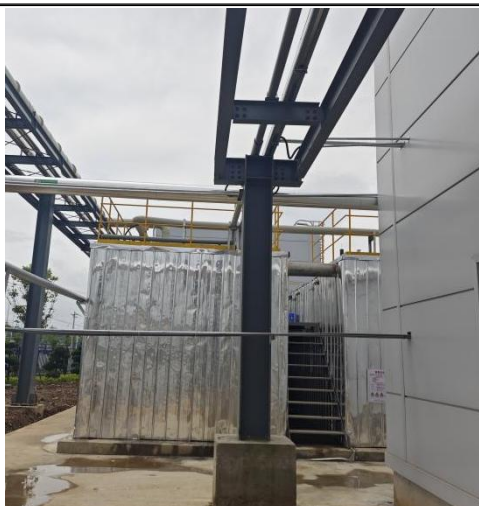
污水处理设施
