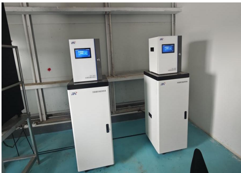
污水在线监测系统
