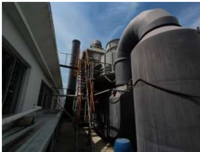
TA002 水喷淋洗涤+间接冷却+静电
