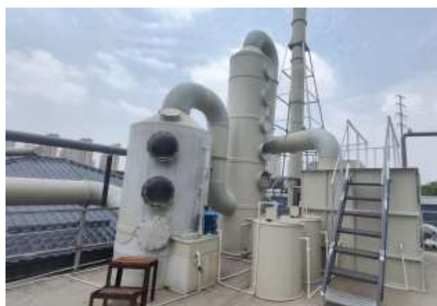
TA004 二级碱液洗涤塔+生物除臭
