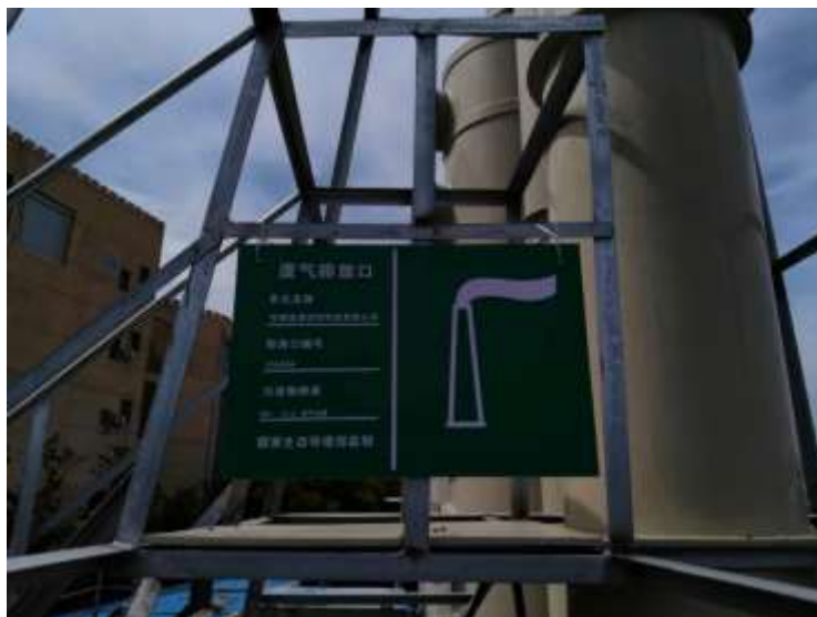
污水处理站废气排口 DA004
