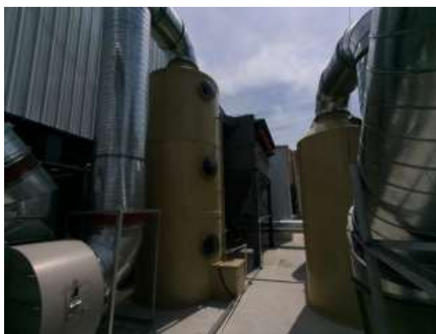
TA001 布袋除尘器+水喷淋
