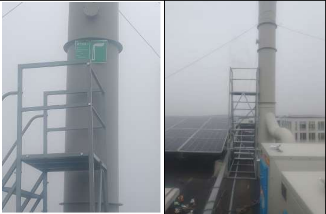
废气排放口标识牌、采样平台、采样口
