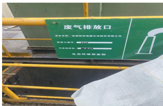
制砂入库斗提废气排放口标识牌
