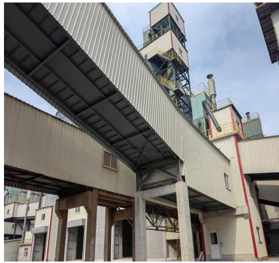
废气密闭、排气筒
