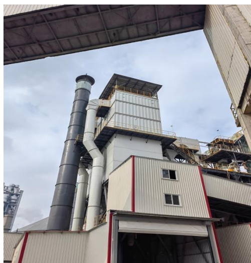
废气密闭、排气筒
