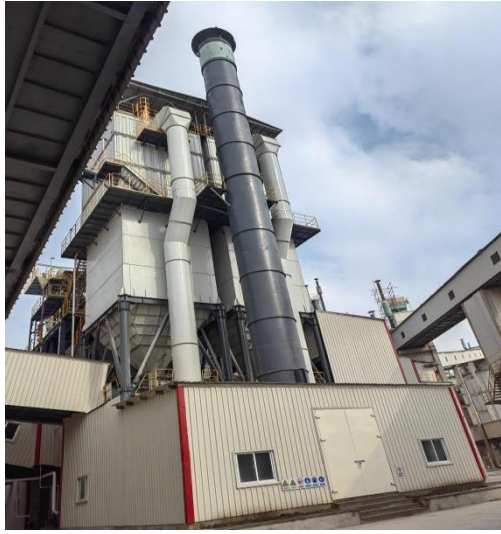
废气密闭、排气筒
