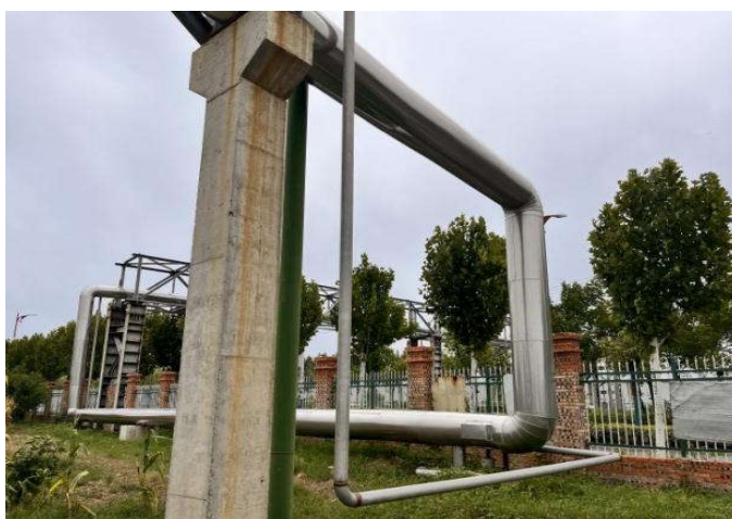
管道输送至丰原2#污水处理厂废水管道
