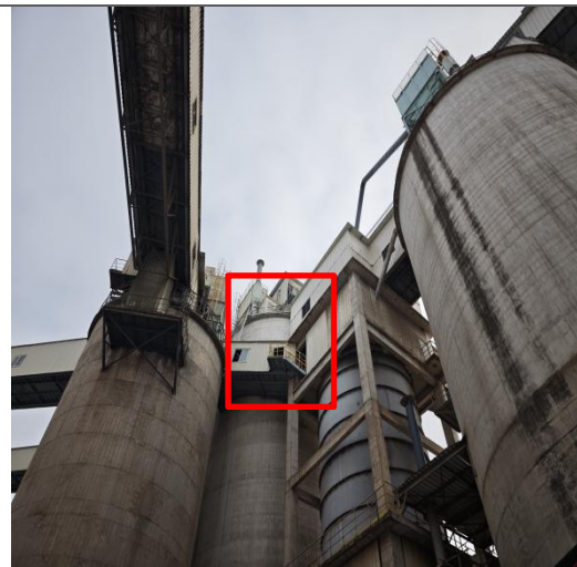
仓顶废气处理设施及排气筒
