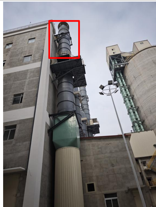
粉磨废气排气筒
