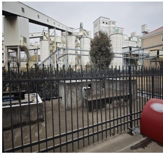
废水处理装置
