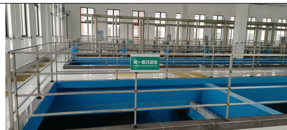
铬一级沉淀池
