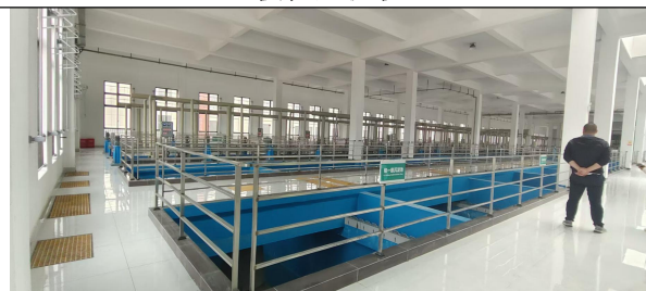
铬一级沉淀池
