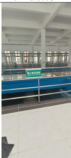
铬二级沉淀池
