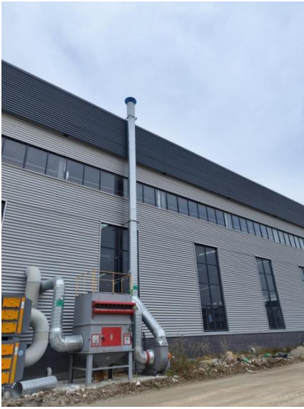
布袋除尘器及排气筒 DA001
