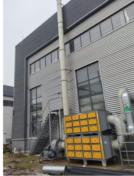
两级活性炭装置及排气筒 DA002
