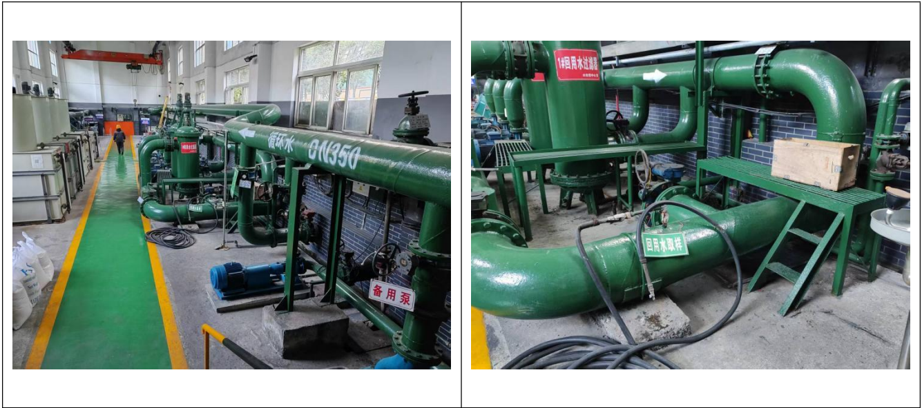
综合污水处理站
