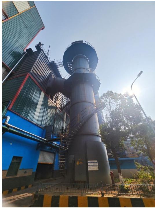
布袋除尘器+DA002 排气筒
