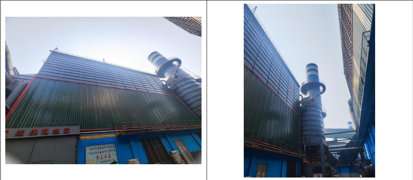
布袋除尘器+DA003 排气筒
