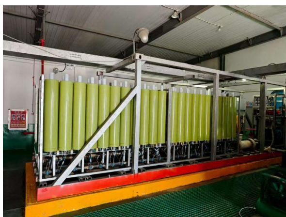
渗滤液 DTRO 膜系统
