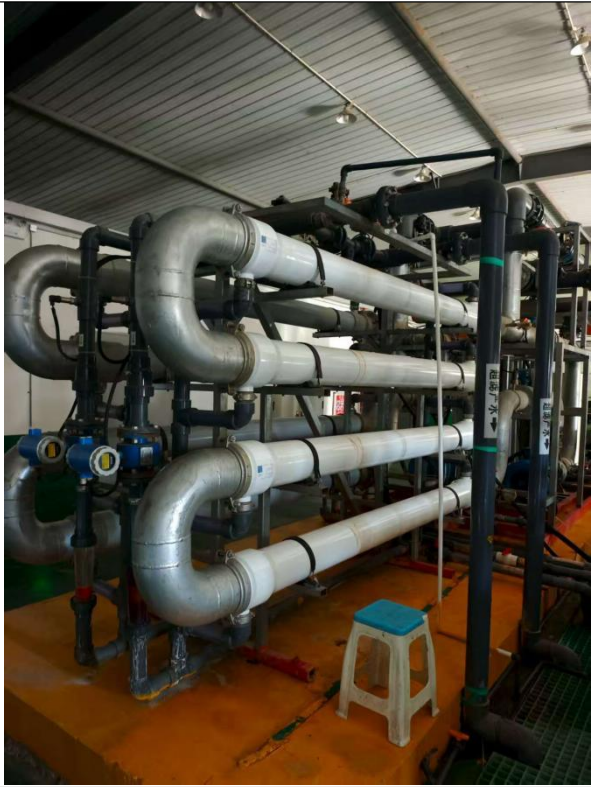
渗滤液 UF 膜系统
