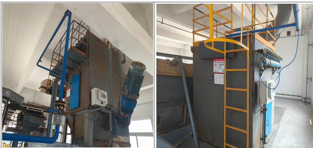
曼海姆生产车间含尘废气袋式除尘器
