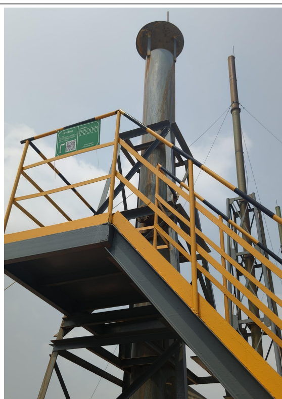
含尘废气排气筒
