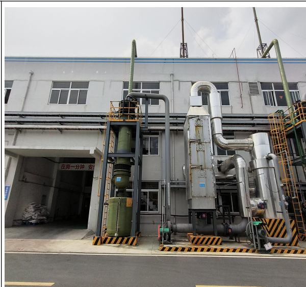
曼海姆炉天然气燃烧废气脱硫脱硝装置
