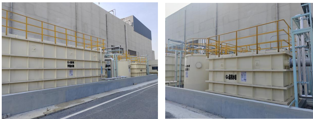
厂区自建酸碱中和处理系统
