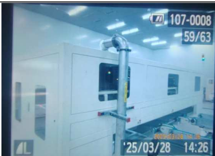
车间废气收集管道
