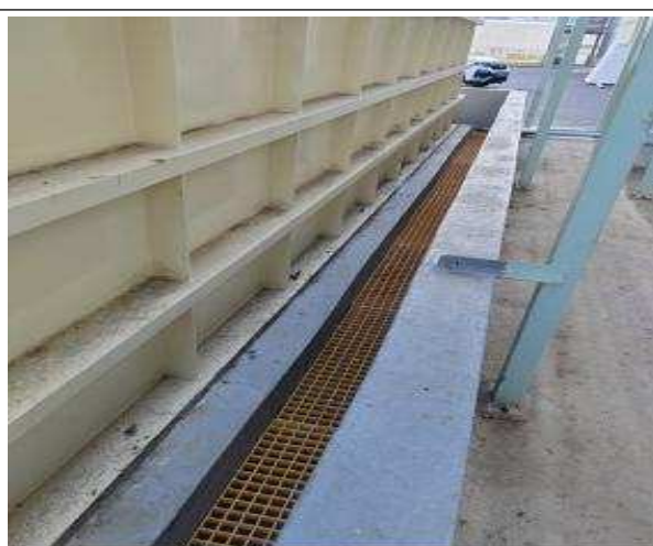
小试线污水处理站围堰
