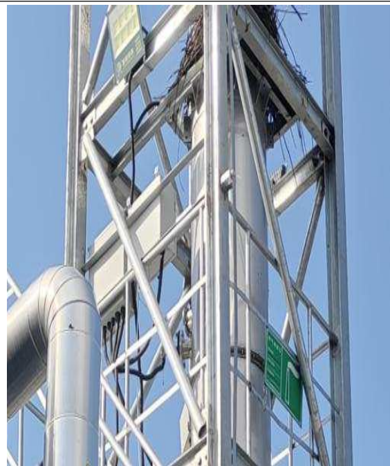
DA003 排口检测孔、标识牌
