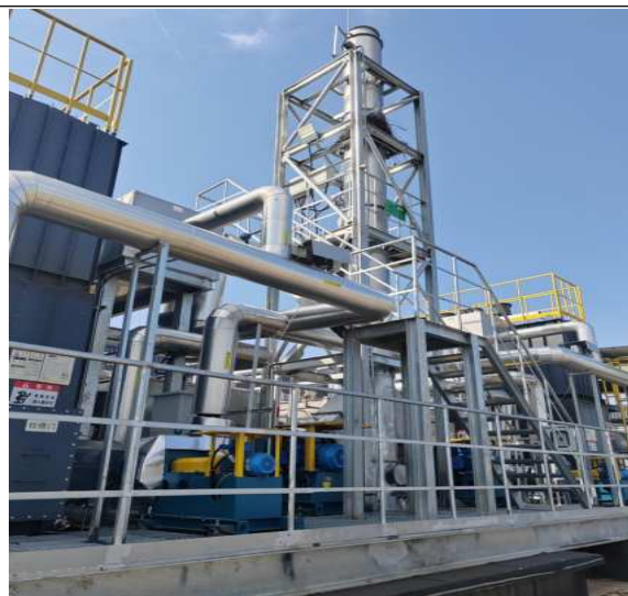
沸石转轮吸附浓缩+RTO 焚烧废气处理设施
