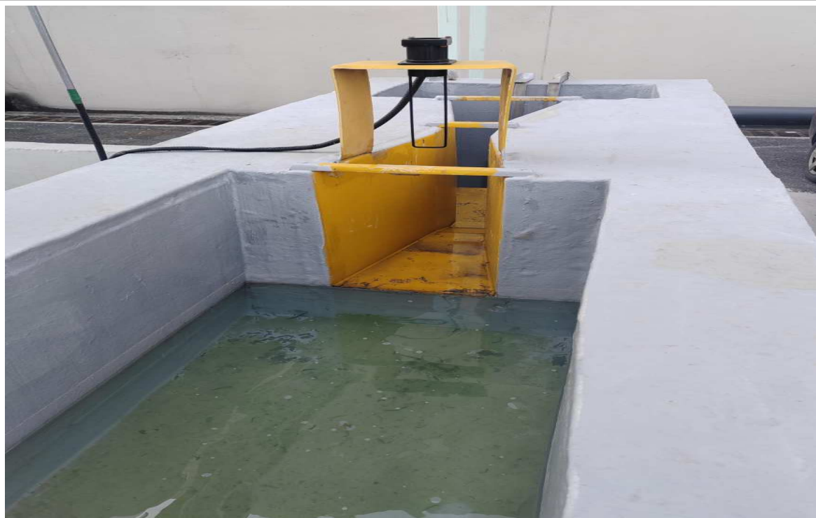
小试线污水处理站
