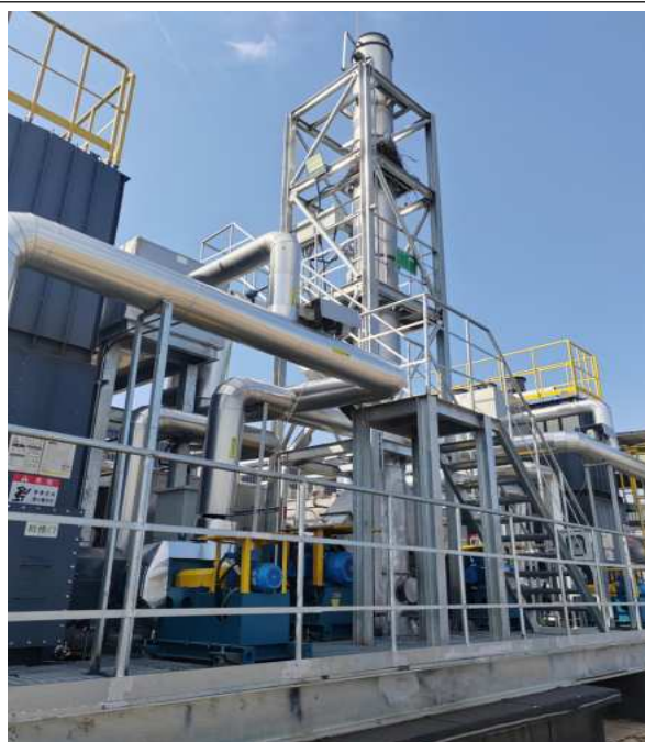
涂布、焊接、层压废气排放口 (DA003)
