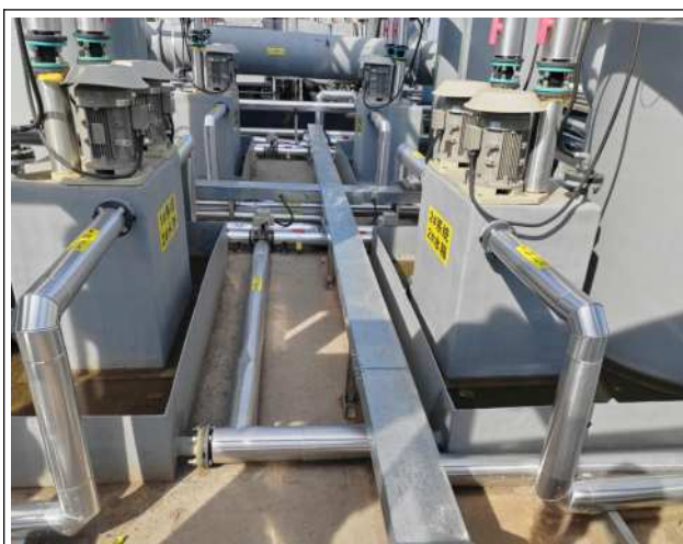
碱喷淋加液箱的防泄漏托盘
