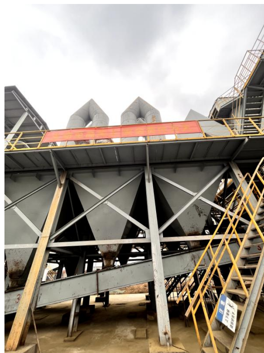
回转窑燃烧废气一次除尘器
