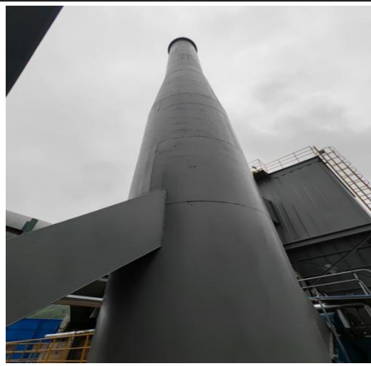
窑头窑尾合并废气排气筒 (DA090)
