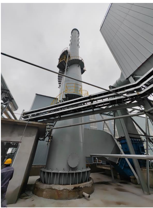
回转窑燃烧废气排气筒 (DA091)
