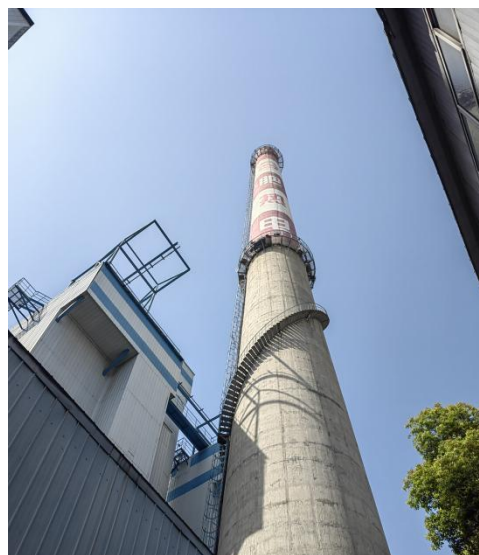
烟气排放连续监测系统所在排气筒
