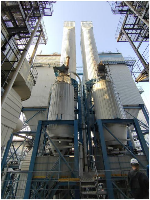
锅炉除尘+脱硫装置
