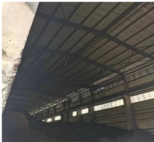
密闭贮煤场及喷淋装置
