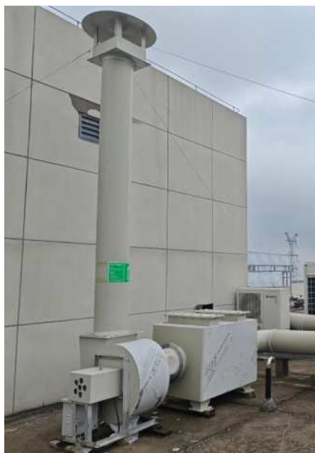
废气排气筒+标识牌
