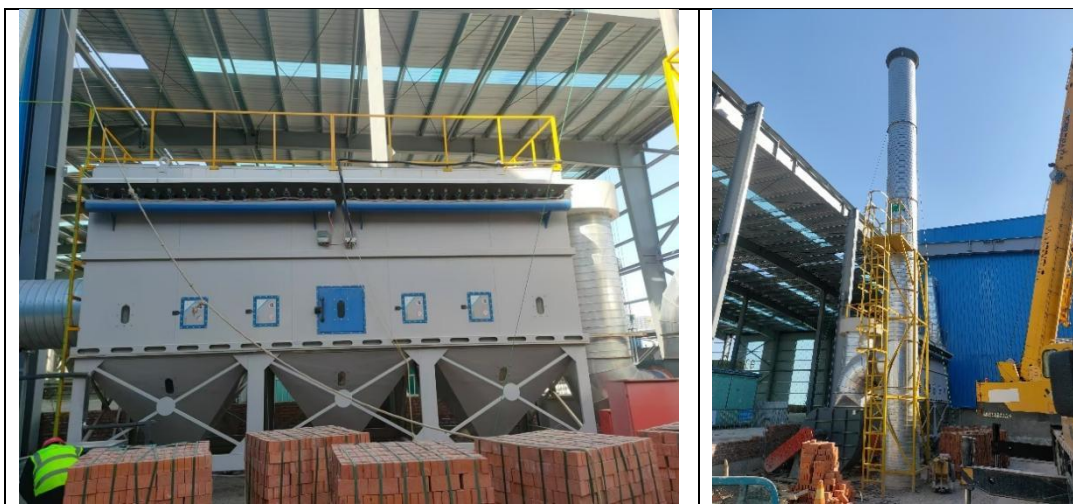
覆膜滤料袋式除尘器+排气筒
