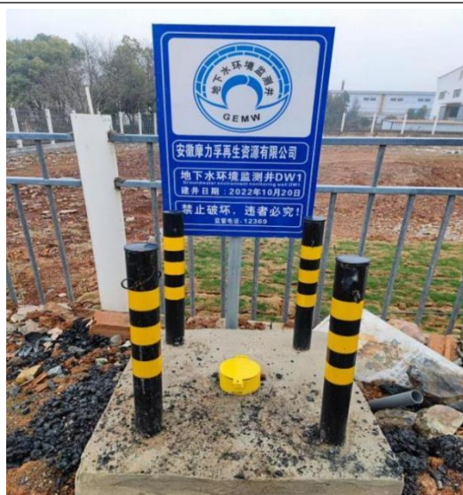
1#地下水监测井
