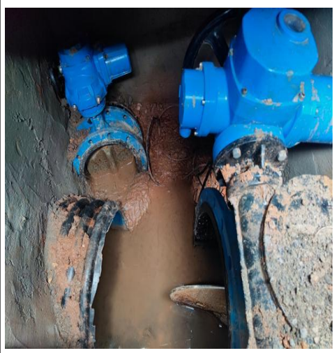
初期雨水池、雨水排口电磁转换阀
