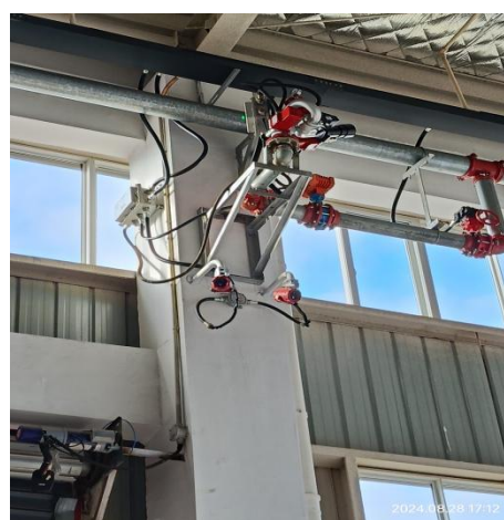
厂房喷淋装置
