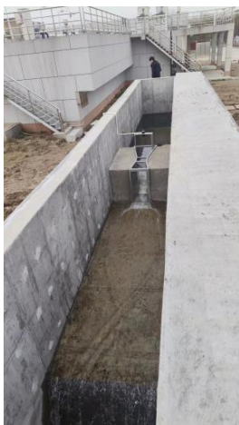
污水厂总排口
