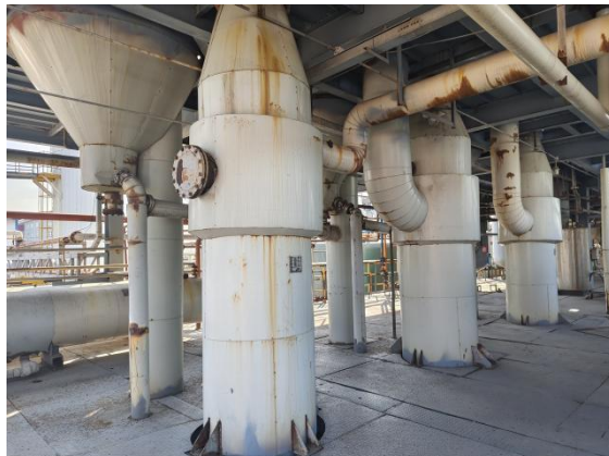
醚化废水三效蒸发器
