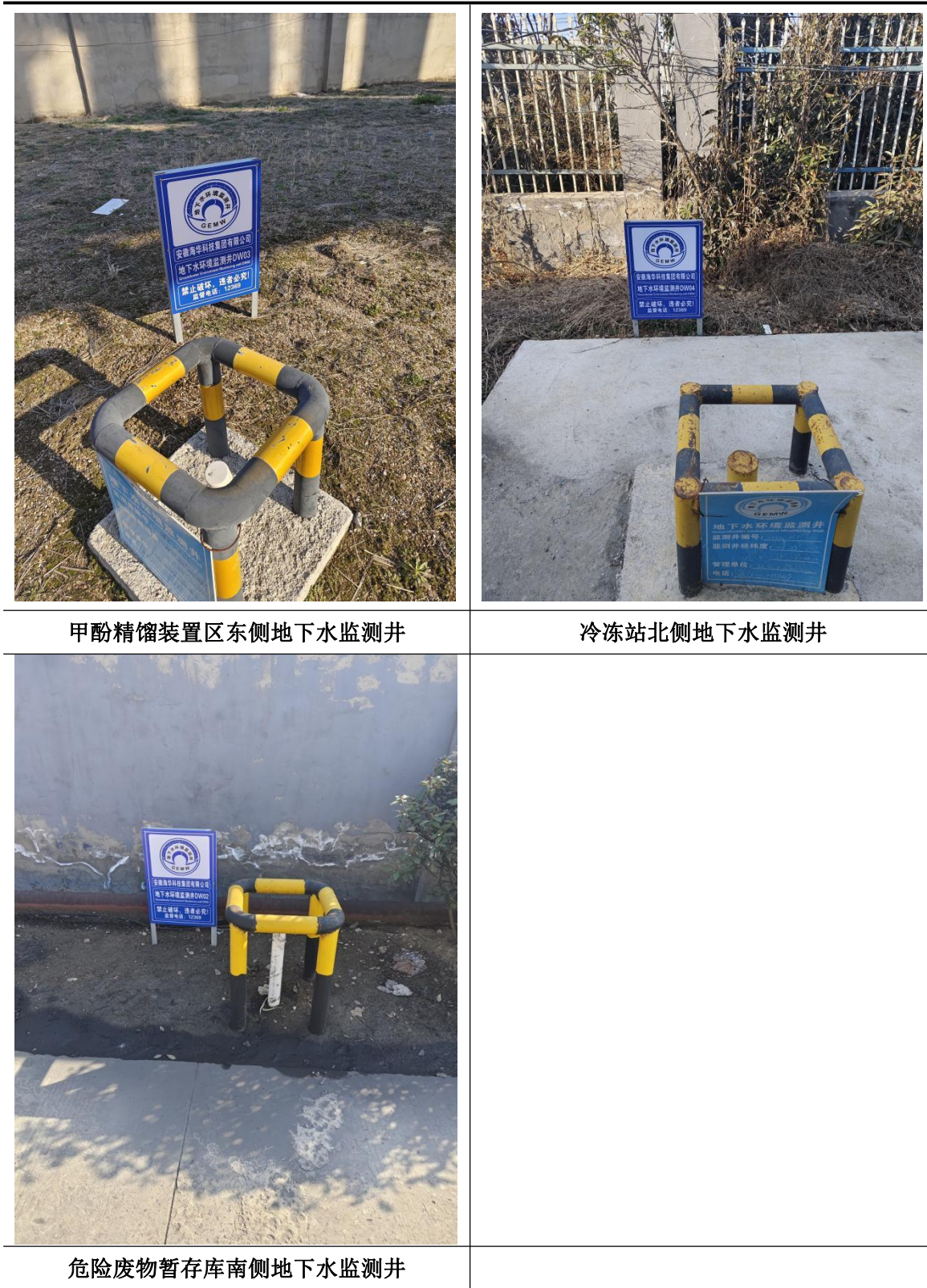
图 4.2-3 地下水监测井照片
