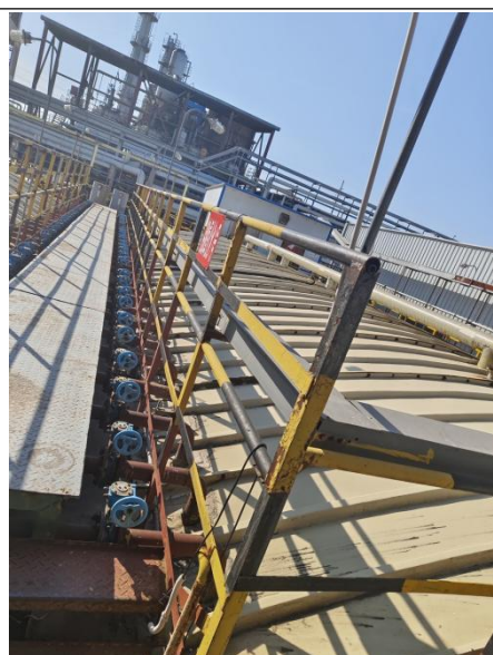
综合污水处理站 B
