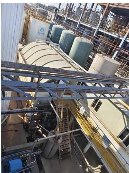
有机废水预处理装置
