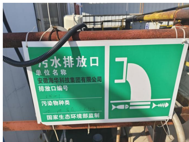
废水排放口标识牌
