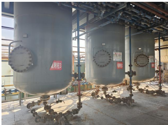
醚化废水三级树脂吸附装置
