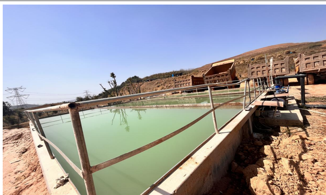
湿式除尘器三级沉淀池
