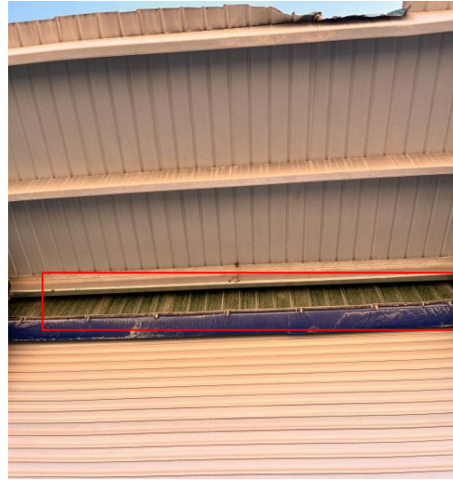
废石仓门口喷淋管
