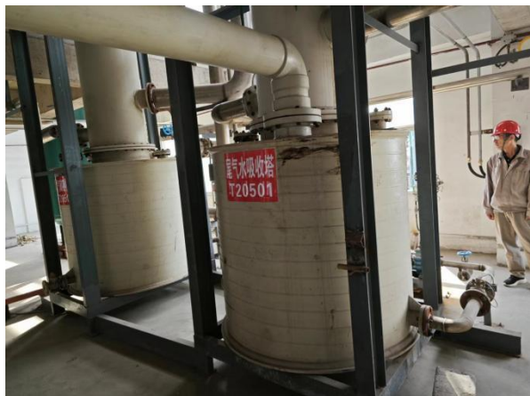
车间水吸收+碱吸收
