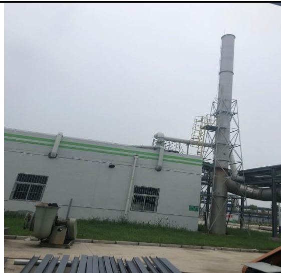
有机废气净化装置排气筒
