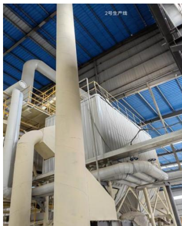
二号生产线废气布袋除尘器
