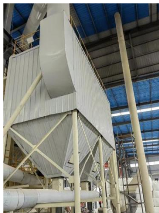
三号生产线废气布袋除尘器
