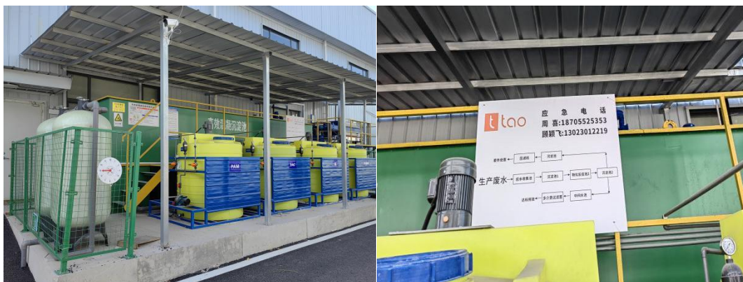
厂区污水处理站
