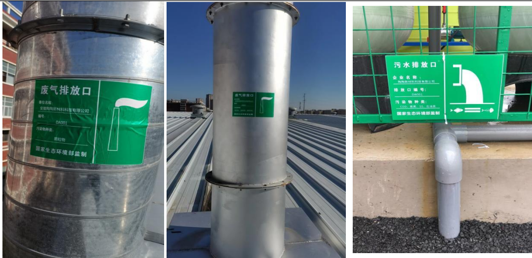
排放口标识牌
