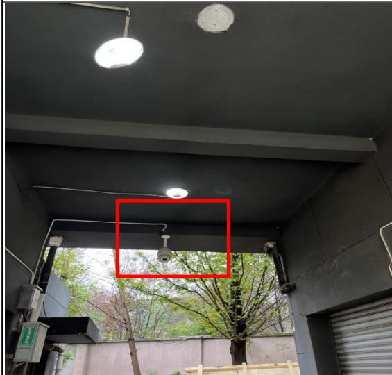
危废库外监控摄像头
