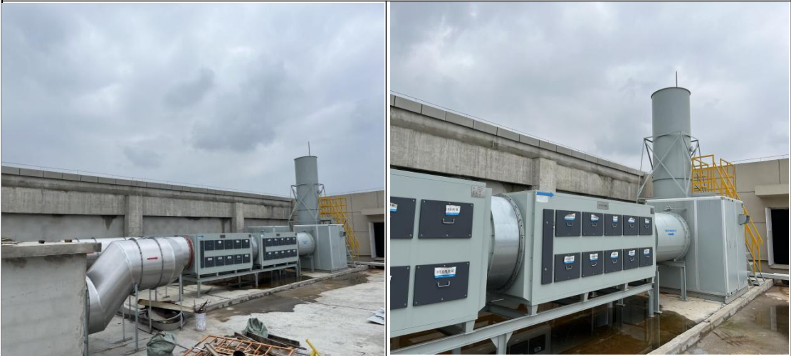
9#生产楼楼顶二级过滤棉+二级活性炭吸附装置
