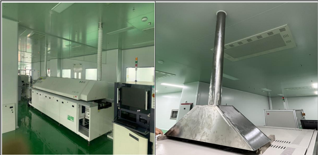
9#生产楼车间废气收集管道
