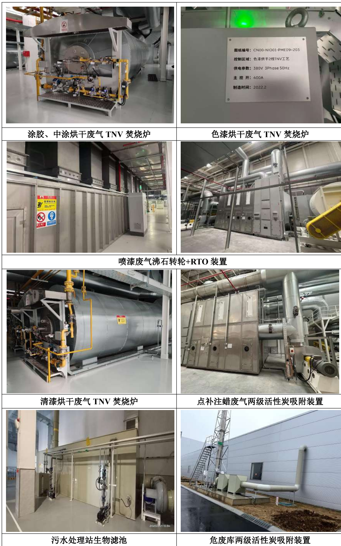
图 4.1-4 废气治理措施照片
