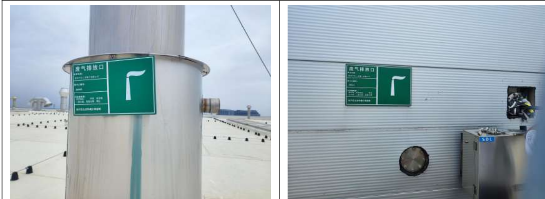
清漆烘干废气排气筒标识牌
