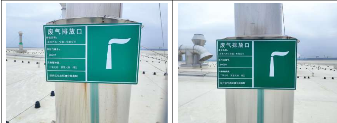
（喷漆；色漆喷漆、色漆闪干；清漆喷漆、流平；色漆套色；色漆套色闪干；清漆套色；喷枪清洗）RTO 废气排气筒标识牌
