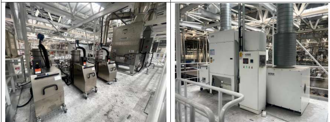
焊装车间铝打磨湿式防爆除尘器
