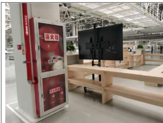
办公楼消防栓
