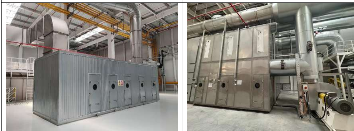
电泳废气（两级活性炭）
