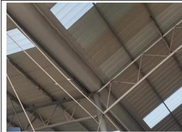
水稳站物料大棚喷淋系统
