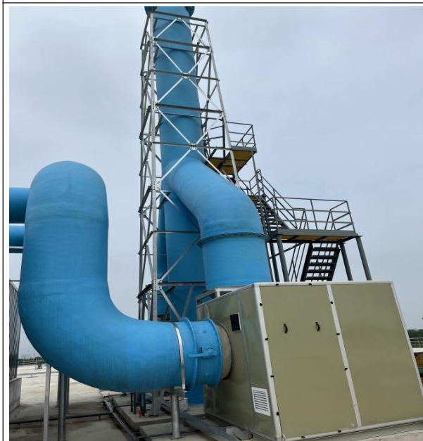
均质调节池/事故池池顶排气筒 1 (DA001)
