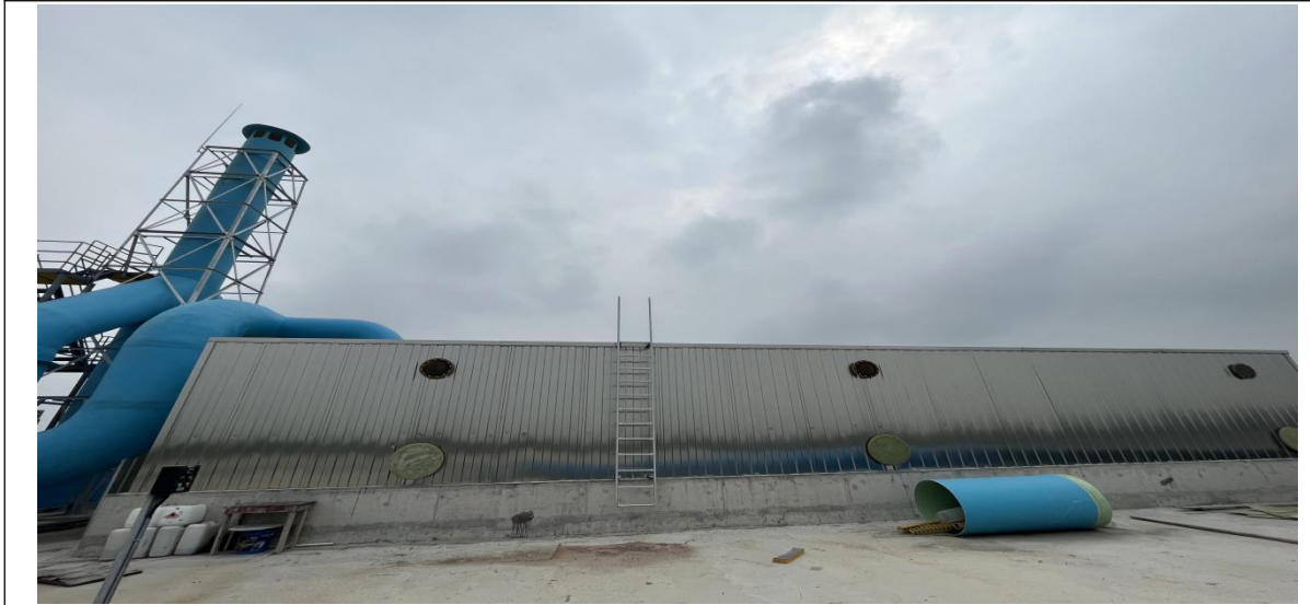
废气收集及处理设施
