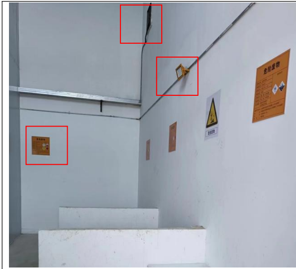
危废暂存间分类存放、通风口、照明
