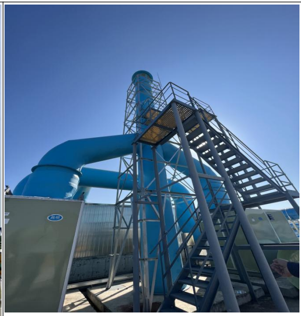
水解酸化/AO生化池池顶排气筒 2 (DA002)
