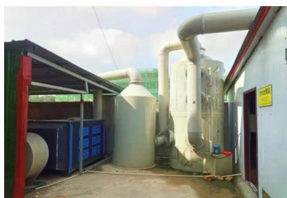
污水处理站废气处理设施及排气筒
