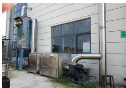
2#车间废气处理设施及排气筒
