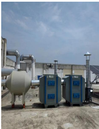
除湿器+两级活性炭吸附装置
