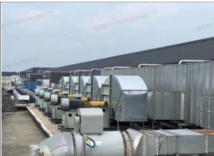
收集后的乙醇废气通过京东方排气管道排放
