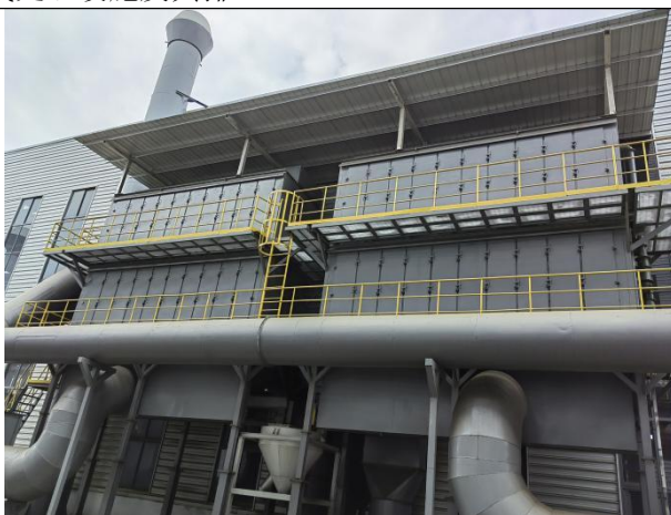
大件打磨废气处理设施-2
