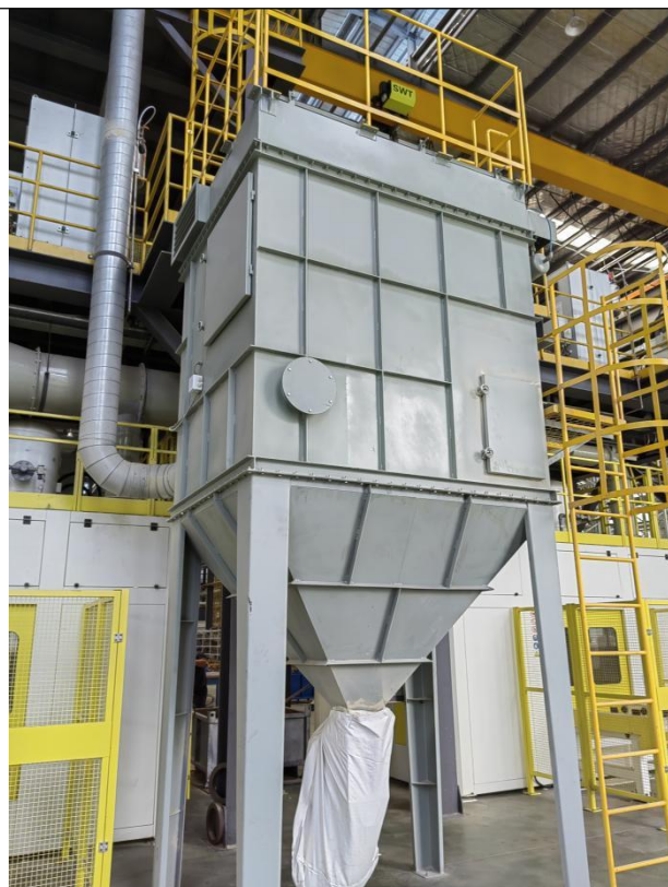
车间内收尘器
