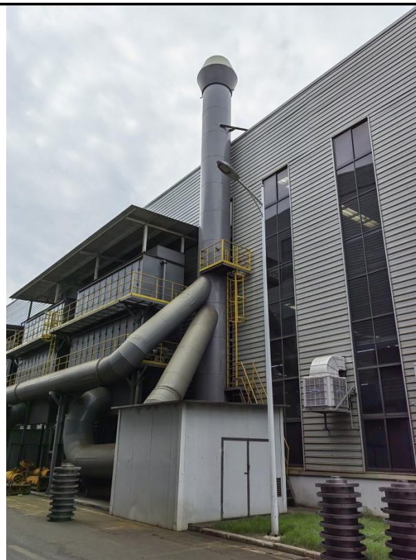
大件打磨废气排口-1
