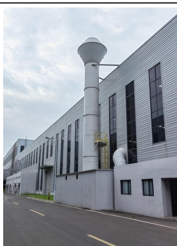
冷却废气排口
