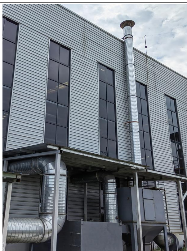
大件精抛和吹灰废气排口
