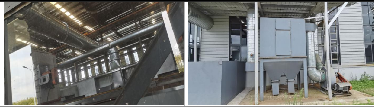
小件喷漆流平烘干废气处理设施及其排口
