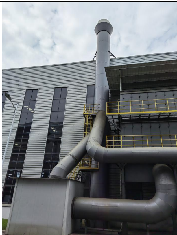
大件打磨废气排口-2
