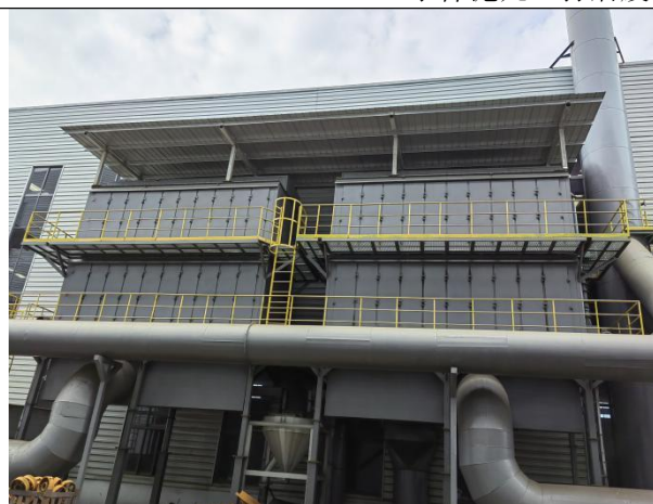
大件打磨废气处理设施-1
