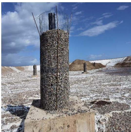
填埋区导气井
