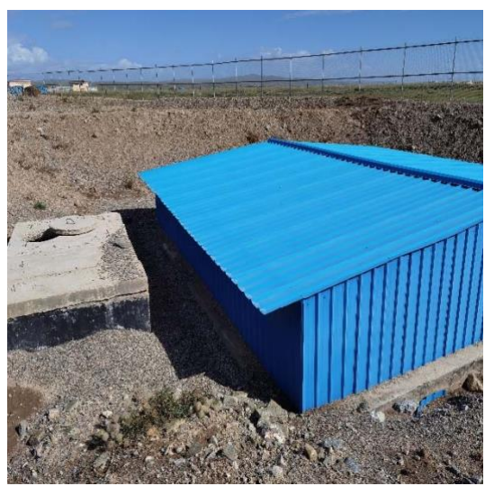
渗滤液集液池及回喷泵井
